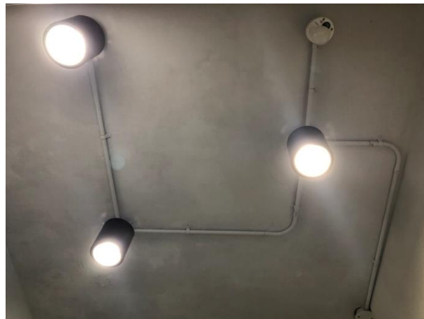
自動照明系統(廁所)、停車場夜間照明
