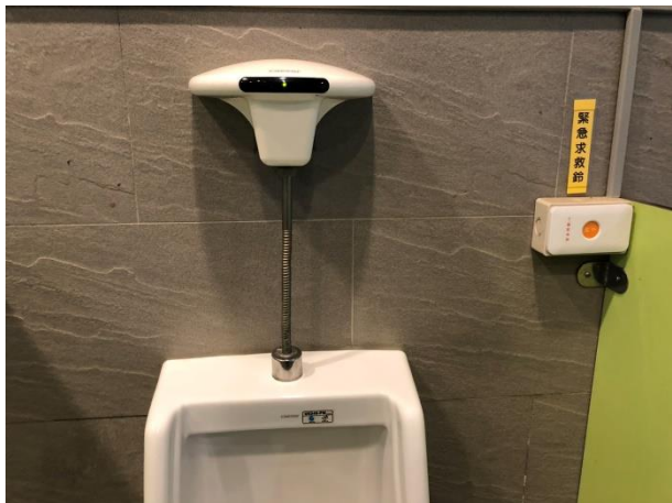
緊急求救設備
